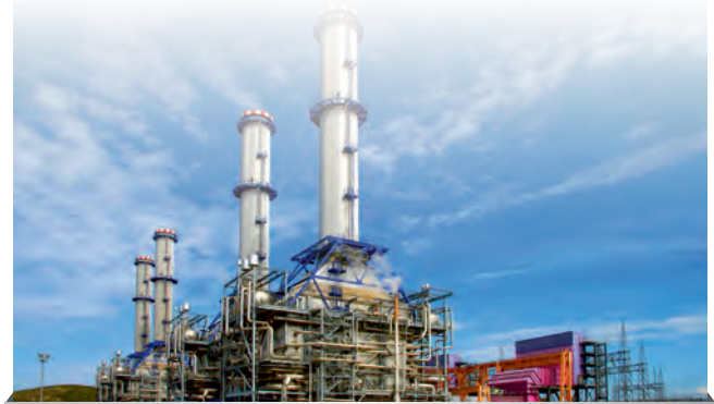
YENI ELEKTRİK 865MW CCPP-TURKEY
